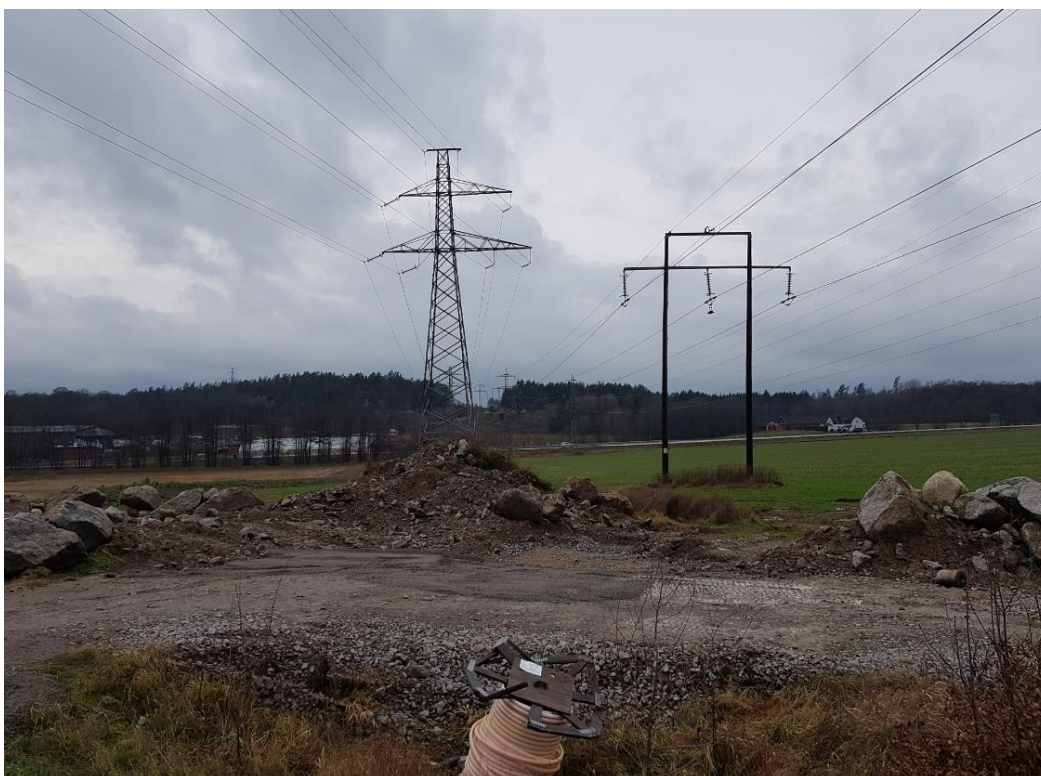
Figur 3: Placering av kraftledningar i södra delen av planområdet. Foto: fältbesök, Sweco 2019.
