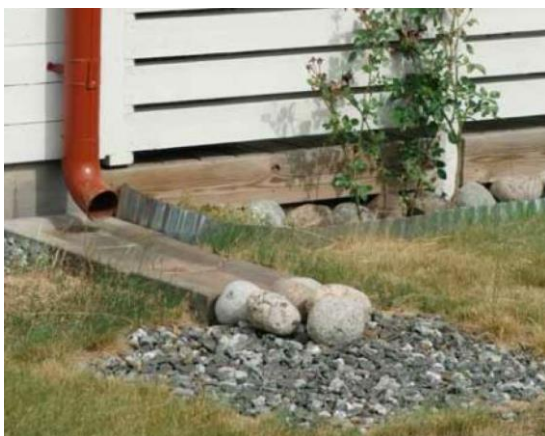
Figur 8: Stuprörutkastare med rännalsplattor med erosionsskydd som leder ut vattnet på gräsmatta. Foto: Dagvattenhandbok Haninge kommun 2019.
