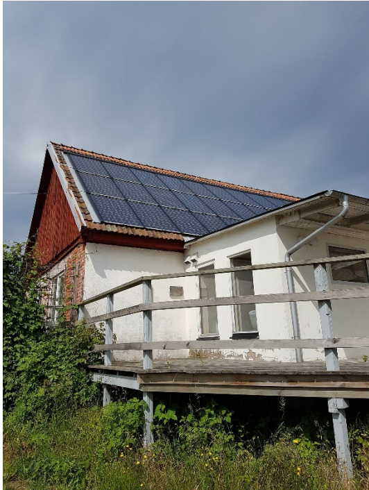
Bild 13. Solceller på taket till stallbyggnaden.
